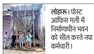
लोहारू। पोस्ट ऑफिस गली में निर्माणाधीन भवन को सील करते नपा कर्मचारी।
